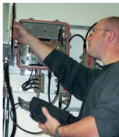
Nodeabnahme durch unseren Bauleiter A. Doce vor der Freischaltung.
